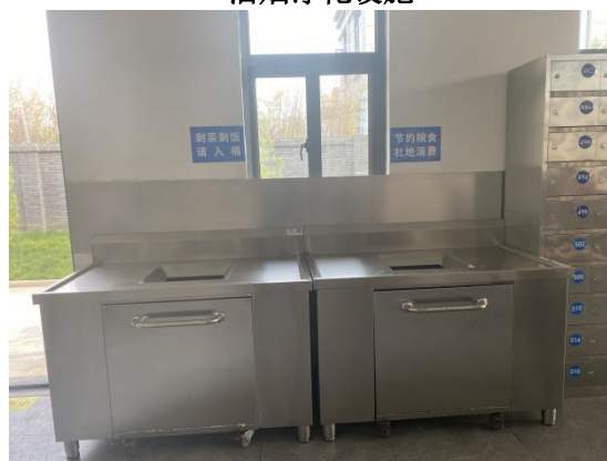
餐厨垃圾收集设施
